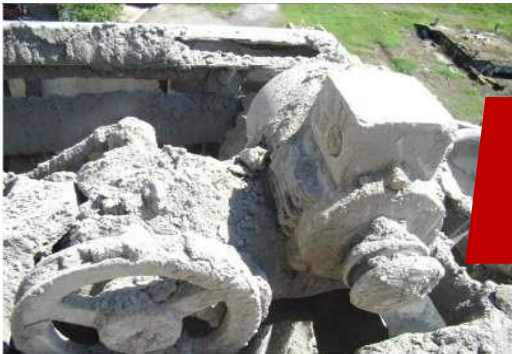
MOTOR VIBRADOR impregnado de cemento
